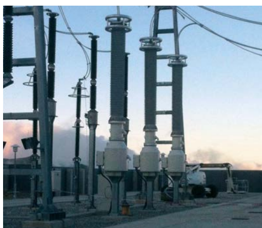
4. Transformador de tensión inductivo de 420 kV. Red Eléctrica de España.
