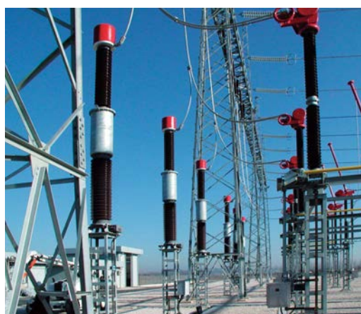
3. Transformadores de tensión inductivos de 420 kV. Rede Eléctrica Nacional (Portugal).
