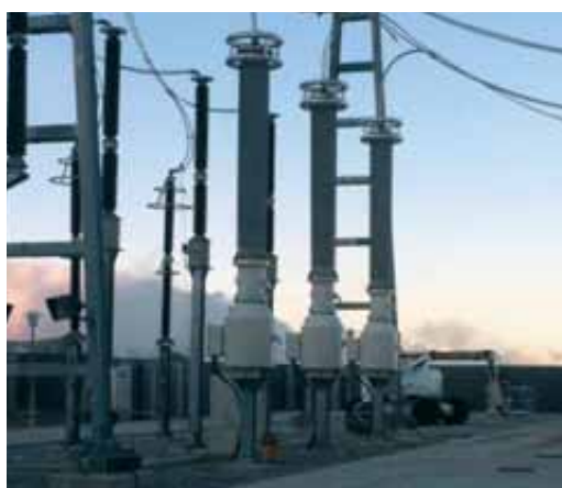
4. Trasformatore di tensione induttivo da 420 kV. Red Eléctrica de España.
